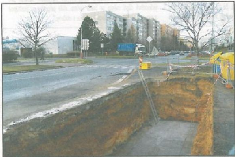
Takto vypadala hluboká jáma na ulici J. Palacha u křižovatky s třídou V. Klementa začátkem prosince, než do ní byly instalovány pomocí autojeřábu čtyři podzemní kontejnery na odpad.
