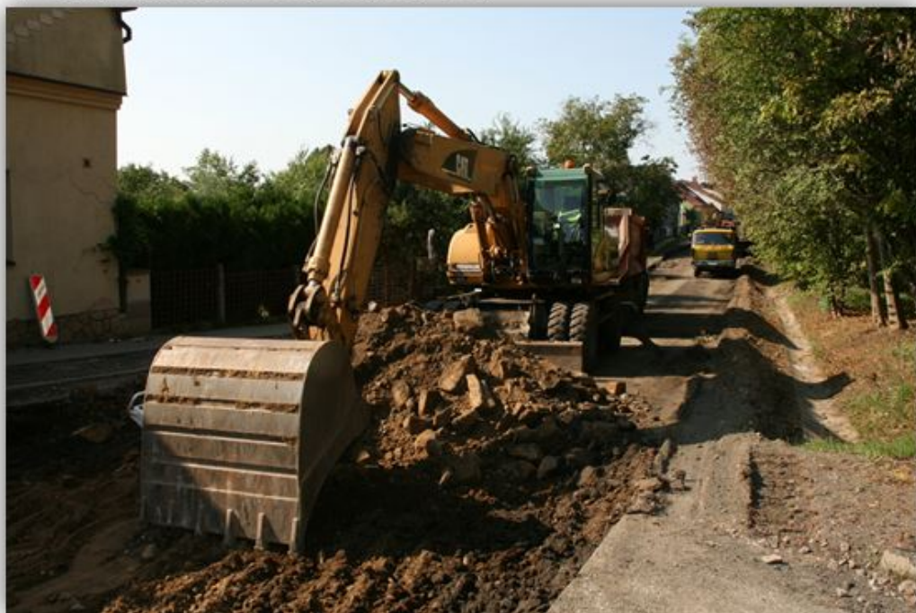
3 Rychle ukrajuje spodek vozovky
