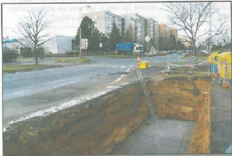
Takto vypadala hluboká jáma na ulici J. Palacha u křižovatky s třídou V. Klementa začátkem prosince, než do ní byly instalovány pomocí autojeřábu čtyři podzemní kontajnery na odpad.
